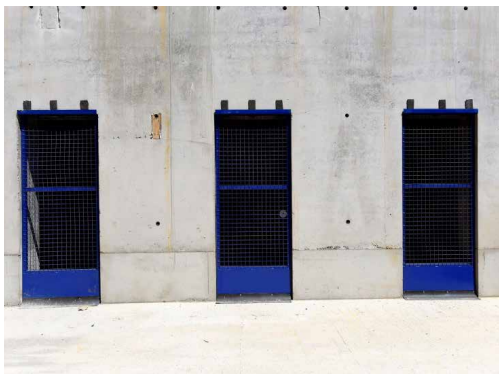
Système de protection des baies d'ascenseurs
